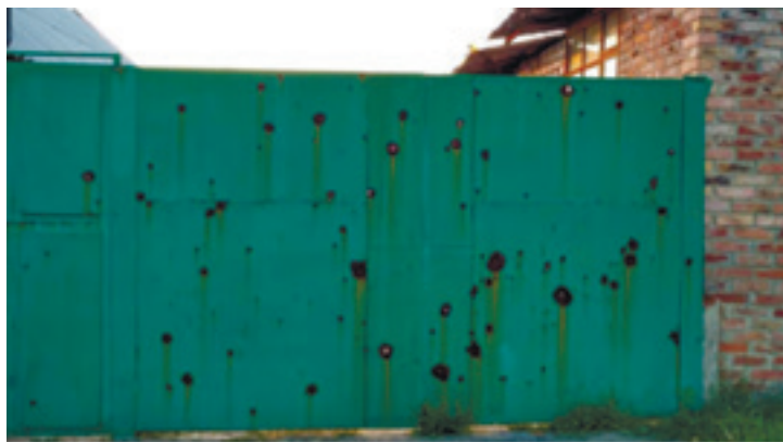
Рис. 4. Ворота приватного будинку, пошкоджені осколками, м. Бахмут, вулиця Шевченко, 91, 18 вересня 2017 року, фото М. Білякової
