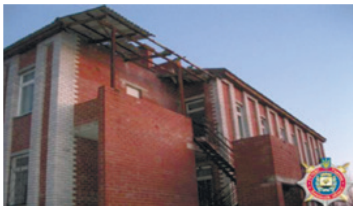
Рис. 1. Пошкодження даху будівлі дитячого садочка «Лелеченька», м. Бахмут, вулиця 1 Загородня, 22, 13 лютого 2015 року, фото представників ГУ МВС України в Донецькій області 2
