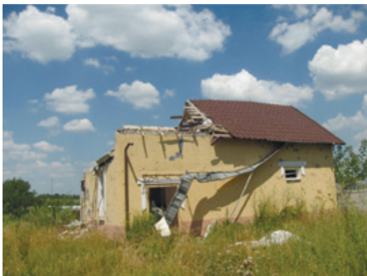
Зруйнований житловий будинок в селищі Зайцеве Бахмутського району Донецької області. Автор – місцевий мешканець В., що вважає за потрібне залишитися анонімним. 2017 рік
